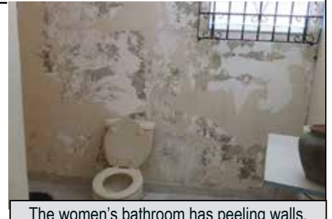
The women's bathroom has peeling walls. El baño de las damas con la pintura descascarillada.
